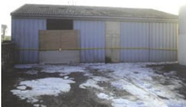
Etat du bâtiment dans la journée du 2 janvier. Les traces au sol ne sont pas de la neige, mais la mousse provoquée par l'action des équipes de lutte contre l'incendie.
